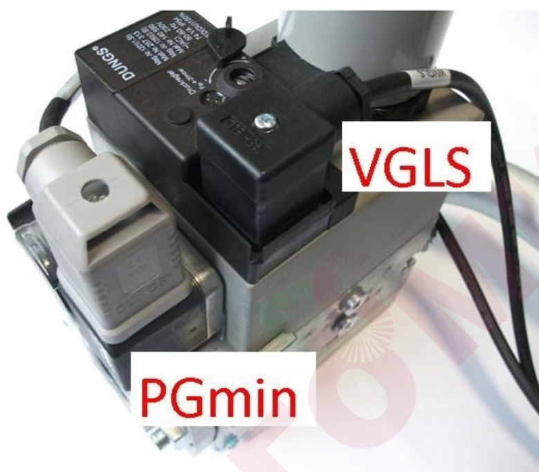
Fig. 9 Электрические соединения к газовой магистрали
