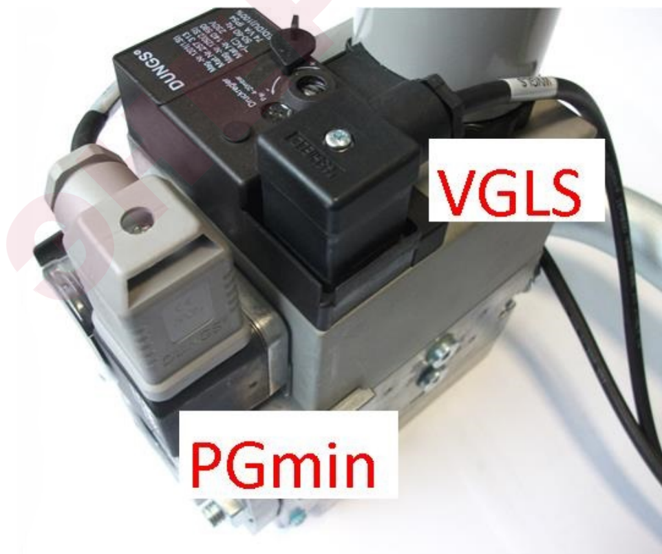
Connessione elettrica rampa gas/Electrical connections to the gas train/Conexiones eléctricas del rampa de gas
